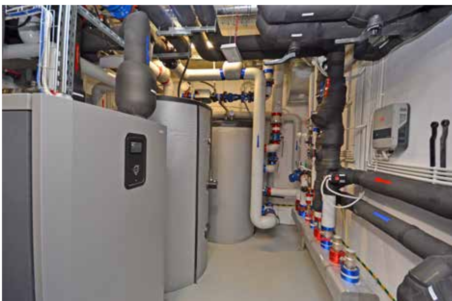
Pompa ciepła Mega (z lewej) w maszynie budynku
