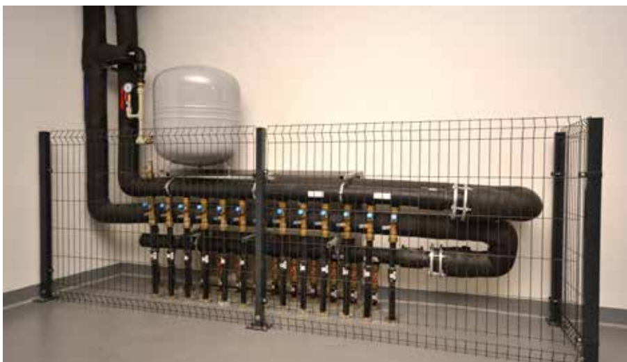
Rozdzielacze dolnego źródła pompy ciepła
