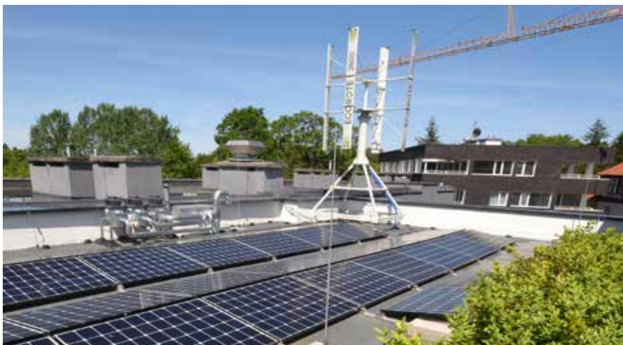
Panele fotowoltaiczne i turbina wiatrowa na dachu budynku
